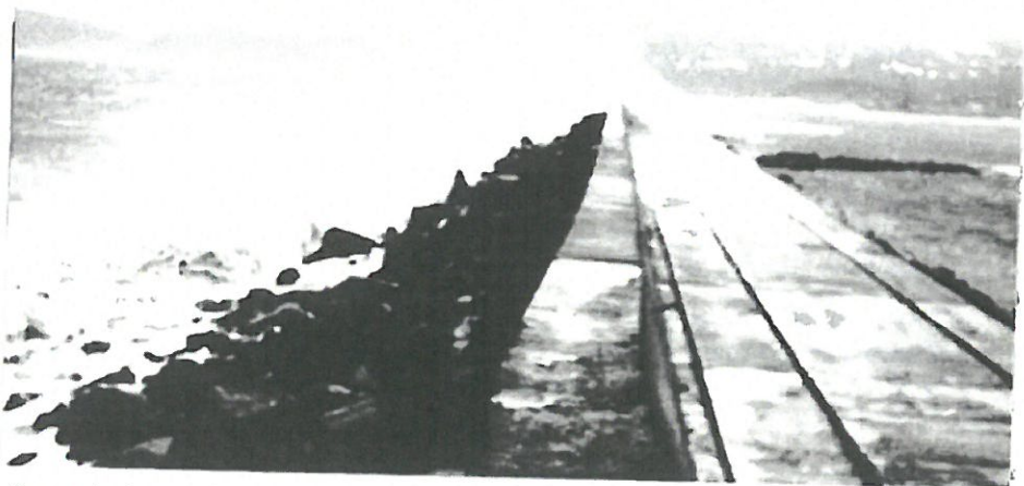
Svartoksmoloen i storm. Sjøen skyller over indre del som er dekket med sprengstein, på ytre del som er dekket med tetrapoder (Ikke synlig på billedet) kan man i slikt vær som regel gå tørt. Steindungen i vannskorpen på innersiden er rester etter stormskaden fra 1932. Haifakranen er flyttet over til Revnes. Foto ca. 1966.
